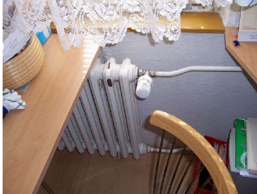
Obrázek 35 Otopné těleso v bytě
