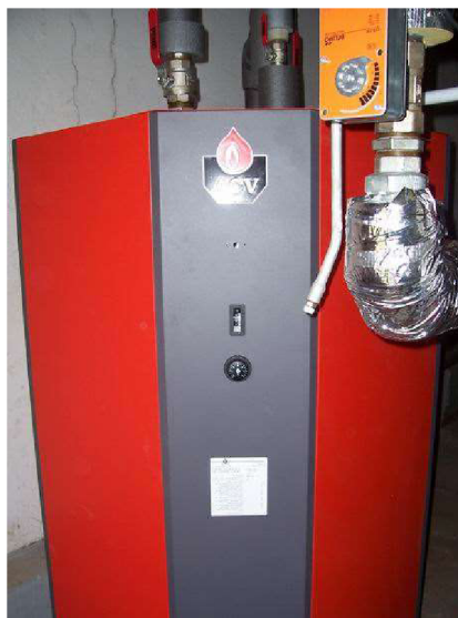
Obrázek 36 Ohříváč teplé vody
