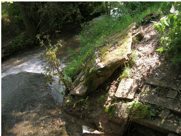
Obr. 7. 7 - Podemílané opevnění spádového stupně
