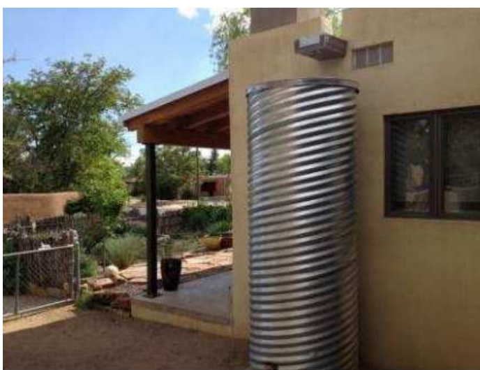
Obr. 12 Akumulace srážkové vody v cisternách
