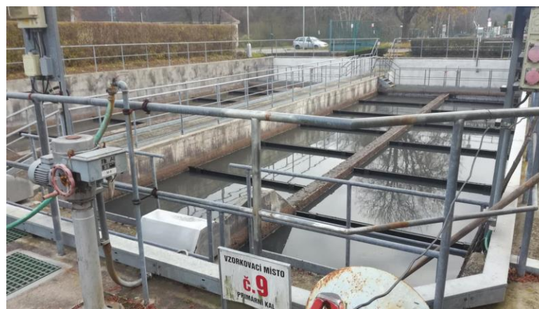
Obr. 8 – Usazovací nádrže, (Alice V.)
