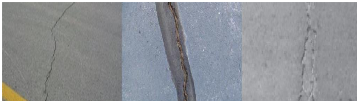
Obr. 9 Priečne trhliny na asfaltových vozovkách [10]
