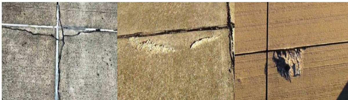
Obr. 15 Odlupovanie spojov a rohov na betónových vozovkách [10]
