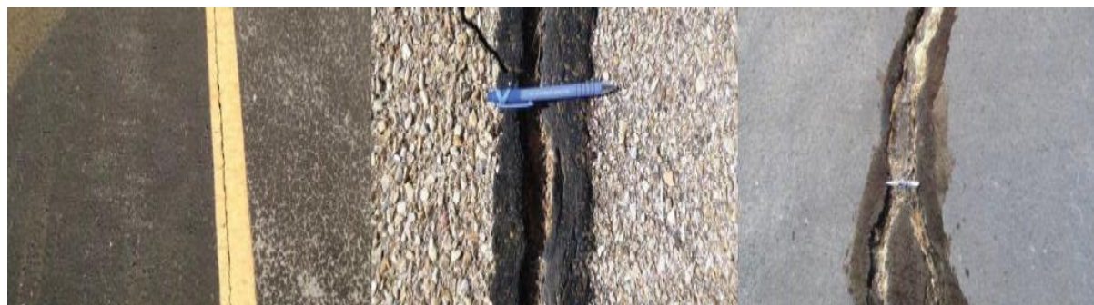
Obr. 8 Pozdĺžne trhliny na asfaltových vozovkách [10]
