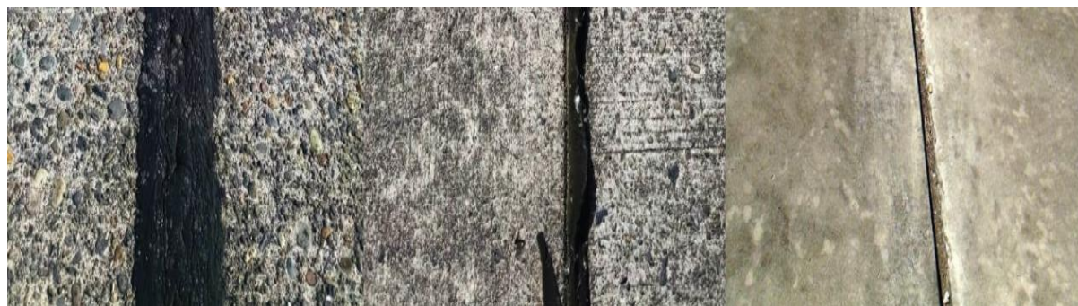
Obr. 18 Poškodenie tesnosti spojov u betónových vozoviek [10]
