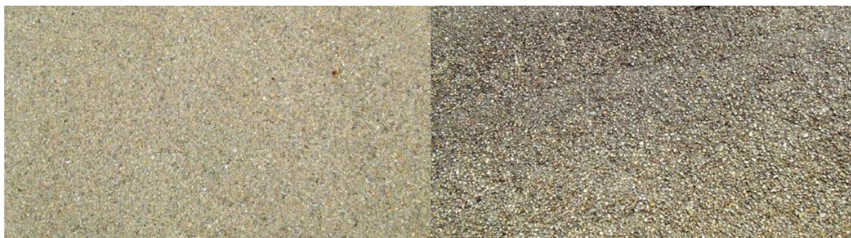
Obr. 14 Zvetrávanie asfaltových vozoviek [10]
