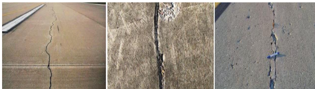
Obr. 11 Pozdĺžne a priečne trhliny na betónových vozovkách [10]
