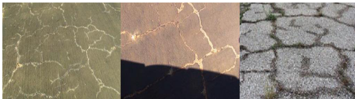
Obr. 10 Blokové trhliny na asfaltových vozovkách [10]
