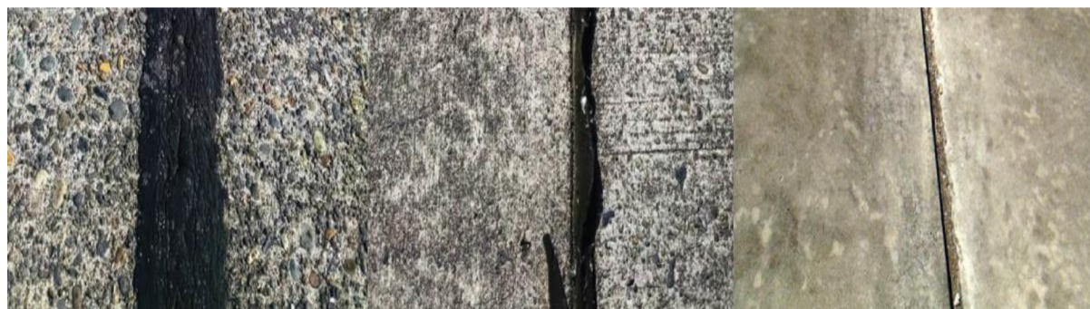
Obr. 18 Poškodenie tesnosti spojov u betónových vozoviek [10]
