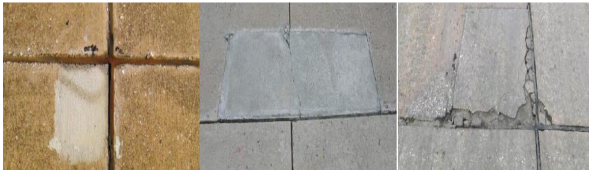
Obr. 16 Záplaty na betónových vozovkách [10]
