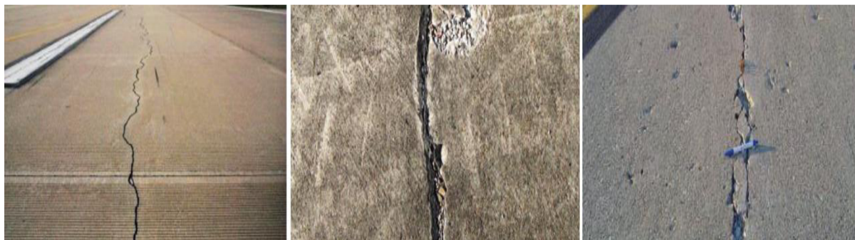
Obr. 11 Pozdĺžne a priečne trhliny na betónových vozovkách [10]
