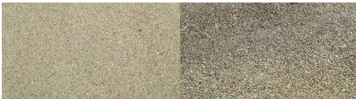
Obr. 14 Zvetrávanie asfaltových vozoviek [10]
