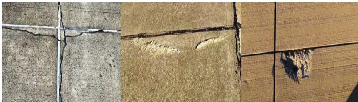
Obr. 15 Odlupovanie spojov a rohov na betónových vozovkách [10]
