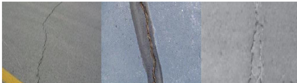
Obr. 9 Priečne trhliny na asfaltových vozovkách [10]
