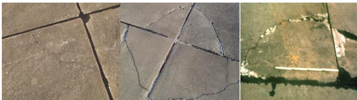
Obr. 12 Rohové zlomy na betónových vozovkách [10]
