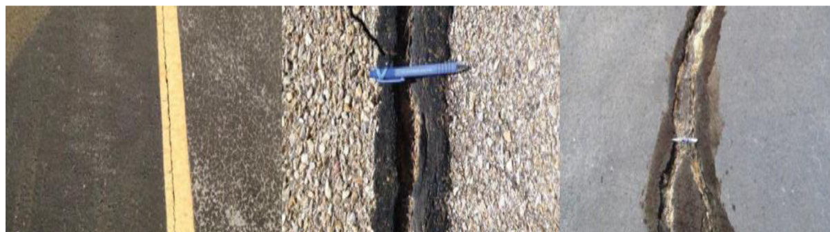
Obr. 8 Pozdĺžne trhliny na asfaltových vozovkách [10]
