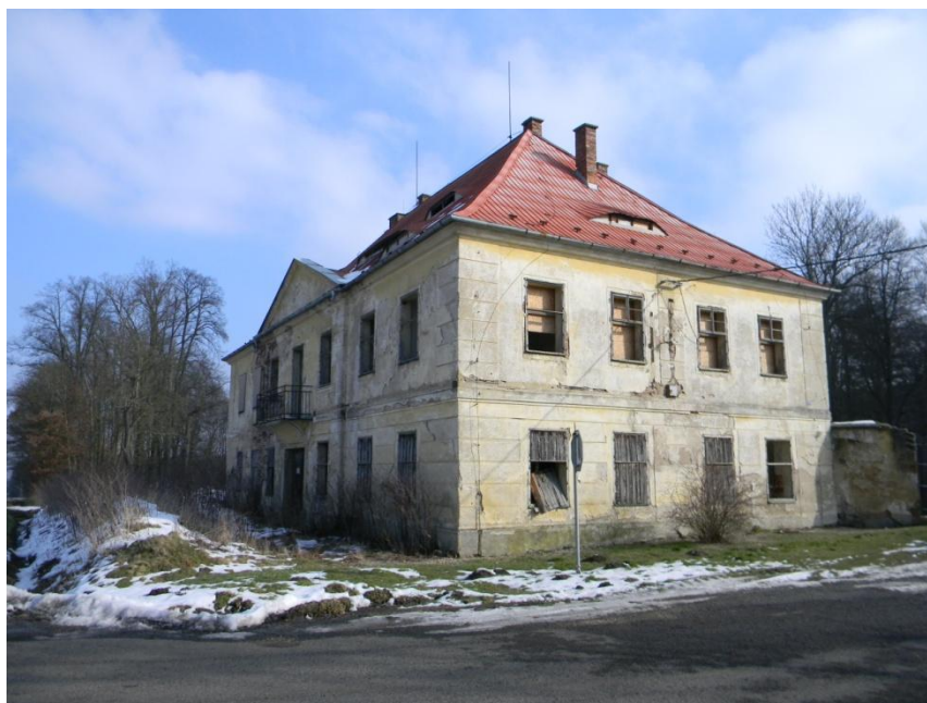
3. Chátrající budova záměčku Spiegel v Arnoltově.
