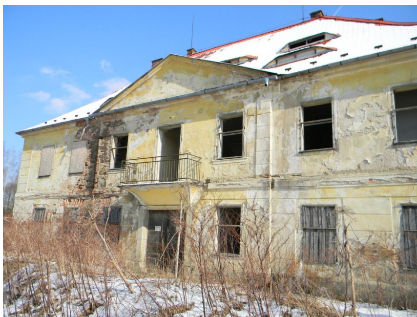
4. Chátrající budova záměčku Spiegel v Arnoltově.
