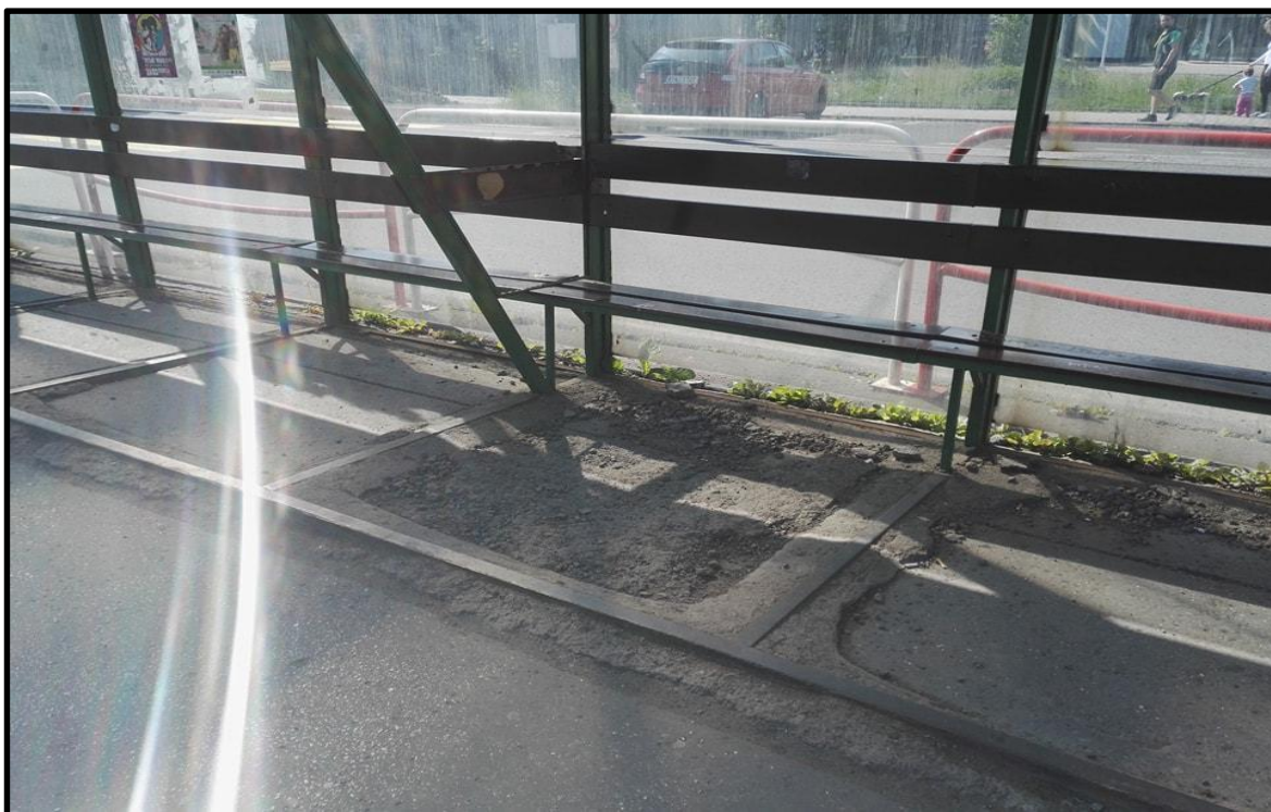
Obr. 7 Aktuální stav autobusového nádraží v Českém Těšíně [Foto autor]
