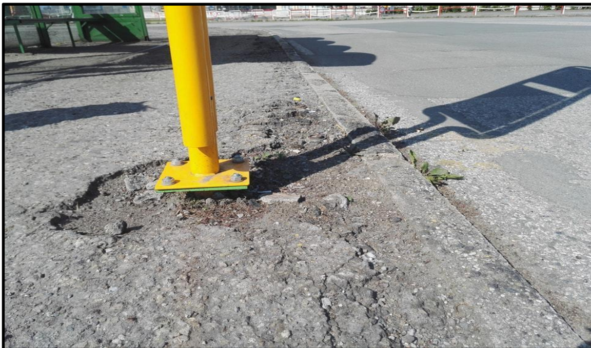
Obr. 6 Aktuální stav autobusového nádraží v Českém Těšíně [Foto autor]
