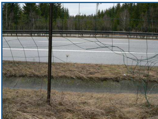
Obr. č. 10 - Příklad poškození plocení v horní části.
