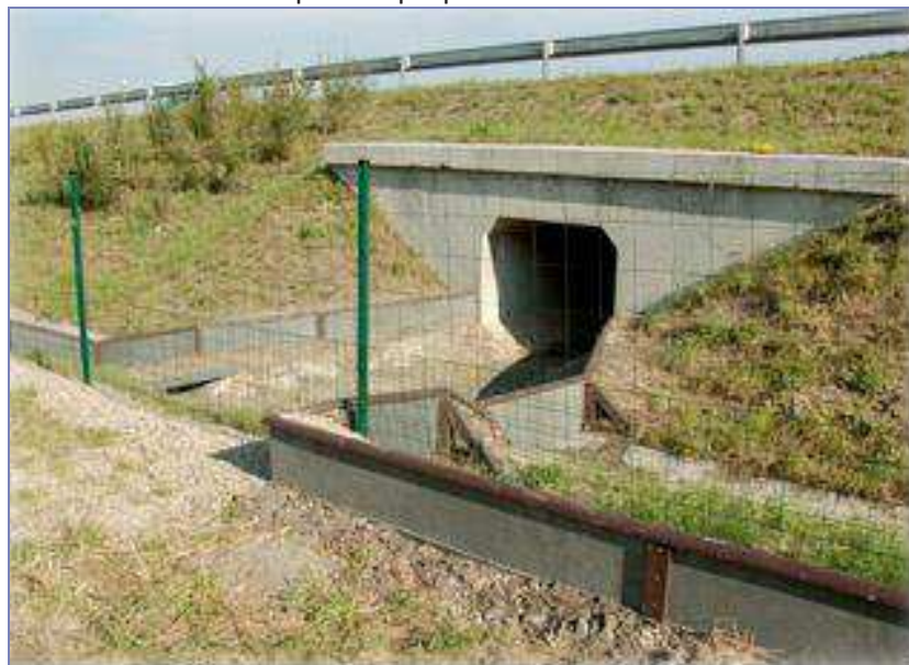
Obr. č. 6: Nevhodné oplocení propustku.
