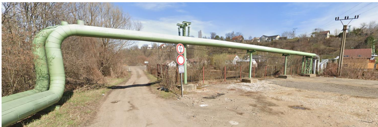
Obr. 28 - Nadzemní horkovodní vedení (foto autor)
