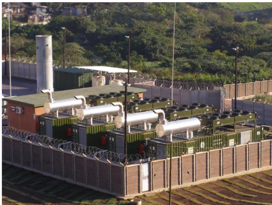
Obr. 7 BPS na využívanie skládkového plynu
