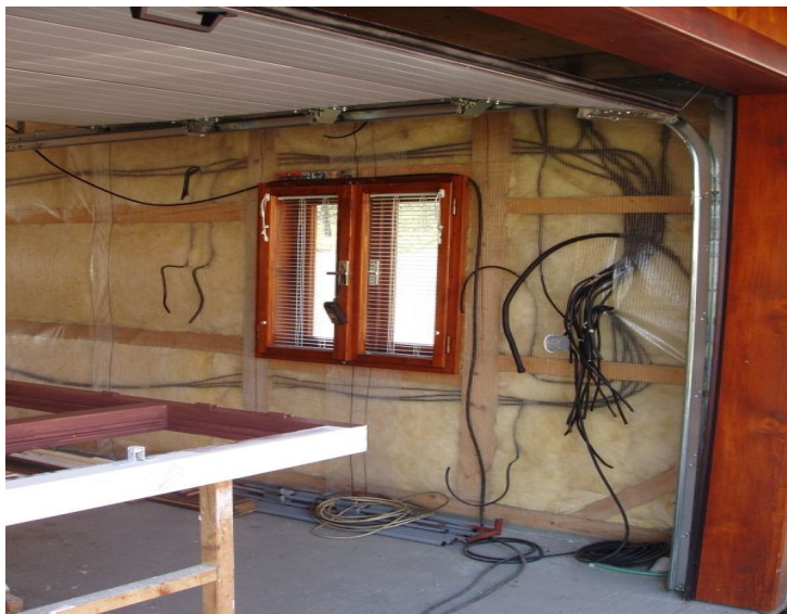
Obrázek 2 Parozábrana v obvodové konstrukci dřevostavby, neošetřené prostupy [8]
