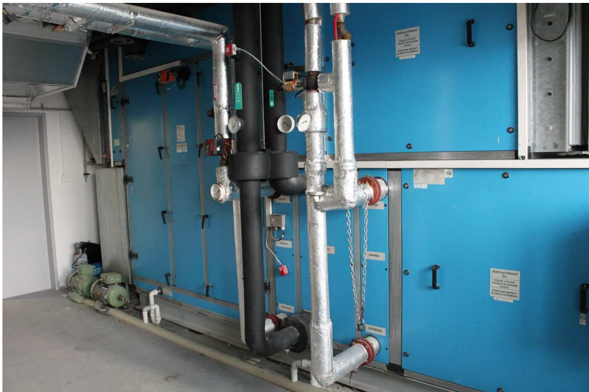
Stávající VZT jednotka Weiss Technik obsluhující čisté prostory
