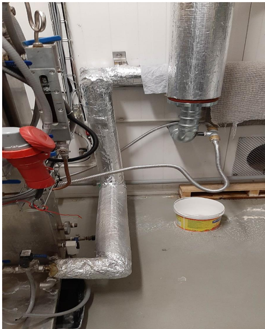
Obr. 7 Parní potrubí vedoucí z kotle do mladinové pánve
