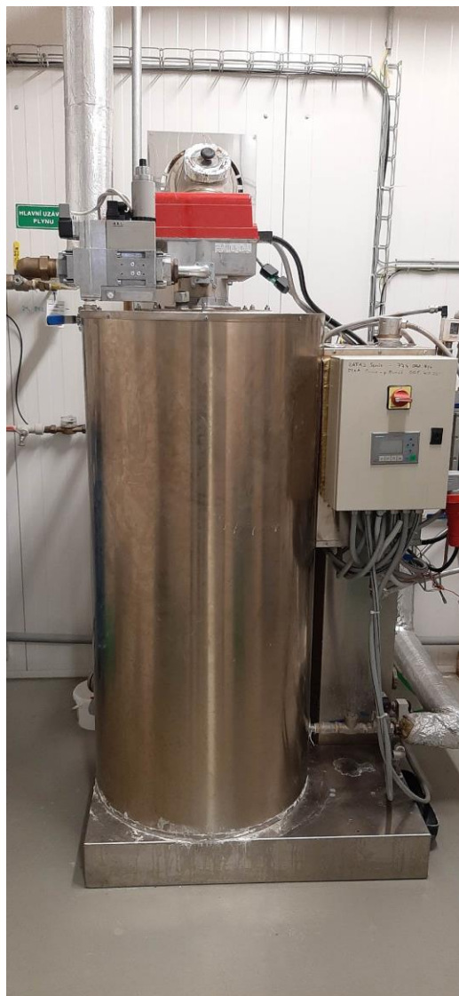
Obr. 9 Parní kotel Anfra
