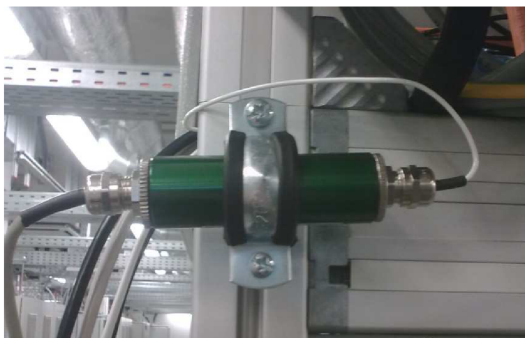
Obr. 60 Umístění zesilovače Burster 9236
