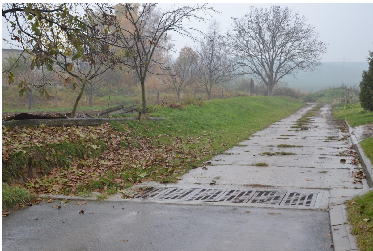
Obrázek 4.12 - Kanalizace v místě kritického bodu č. 2
