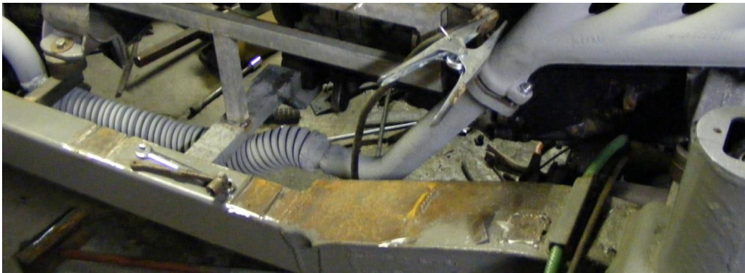
Obrázek 11 Flexibilní hadice výfukového potrubí.
