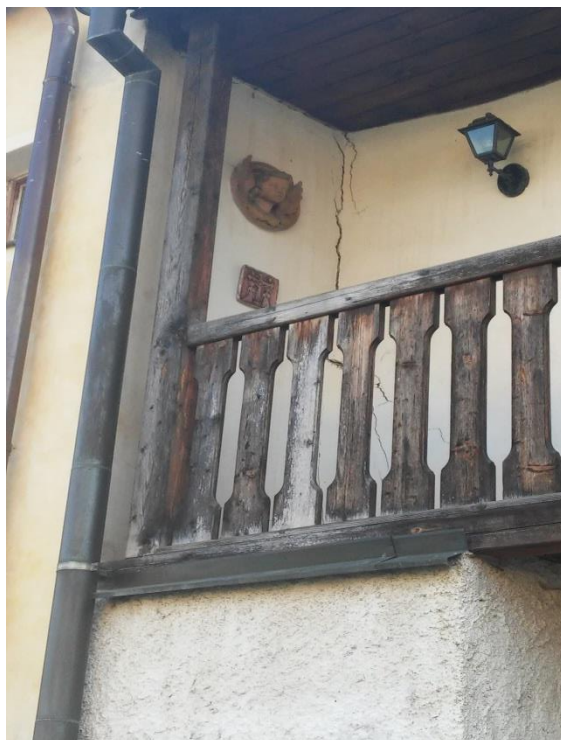
Obrázek 4 Popraskané zdi domů (vlastní zdroj)
