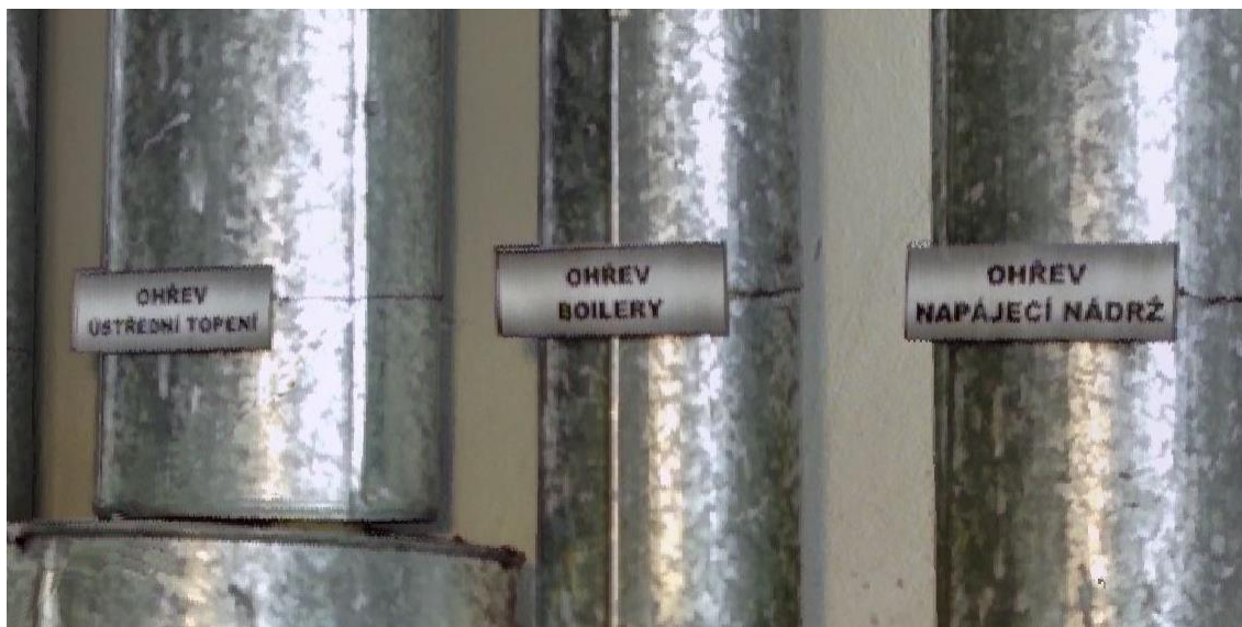
Obr. 6-13 Nápis na potrubí z kolektoru
