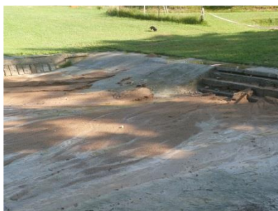
Obr. č. 7: Detail zanesené požární nádrže
