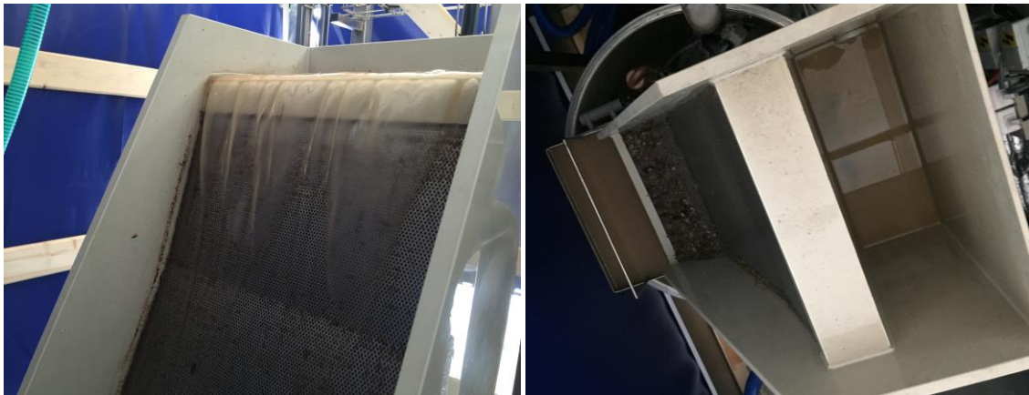
Obr. 22 Poloprovzní AnMBR - nevhodný tvar přelivné hrany a velký sklon spádového síta (foto autor)
