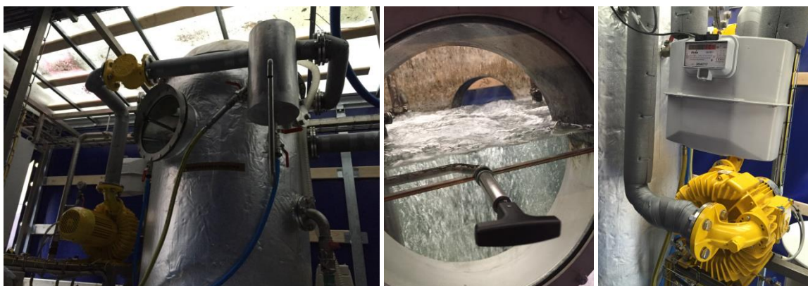
Obr. 18 Poloprovozní AnMBR - plynové hospodářství (foto autor)
