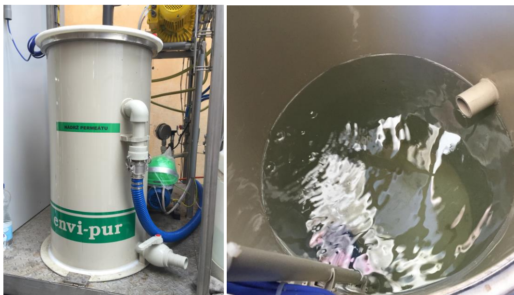
Obr. 16 Poloprovozní AnMBR - nádrž permeátu (foto autor)
