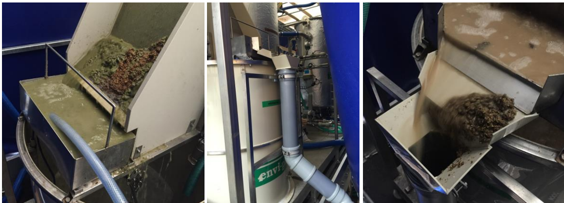
Obr. 23 Poloprovzní AnMBR - zahlcení sběrného koše mechanického předčištění a dobudování přepadu na shrabky (foto autor)
