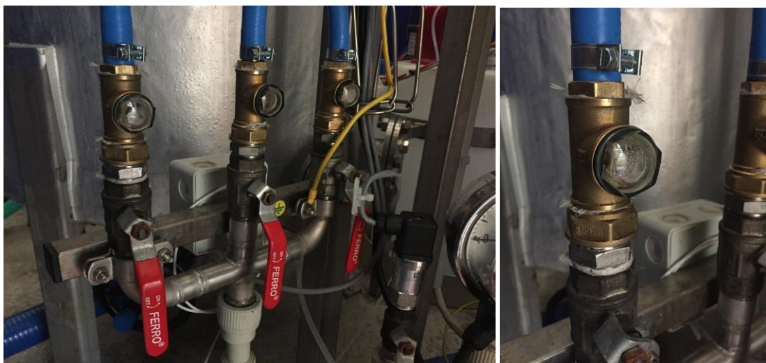
Obr. 26 Poloprovozní AnMBR - dodatečně osazená průhledítka na jednotlivých větvích permeátu (foto autor)
