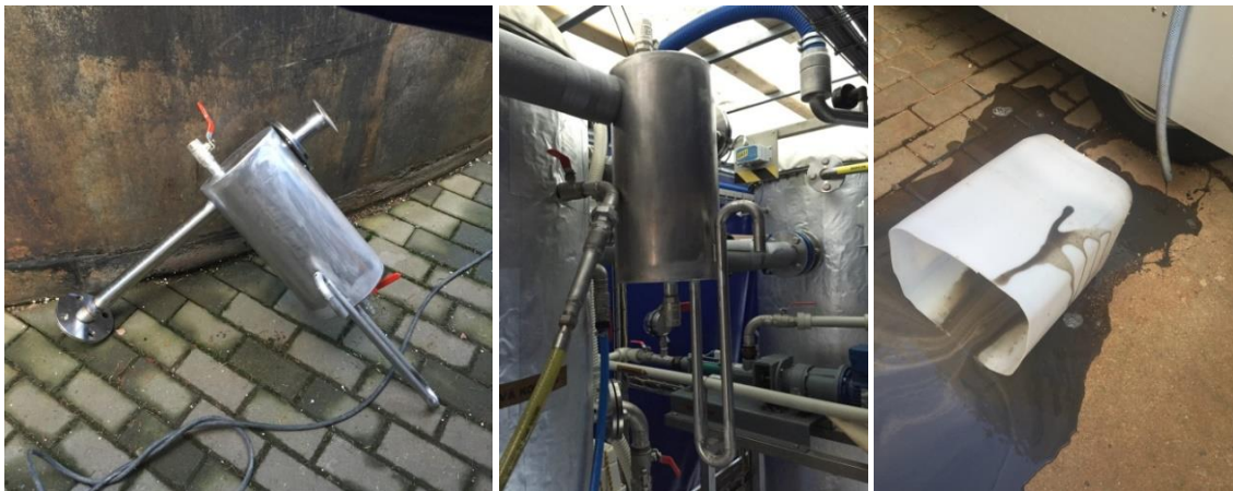
Obr. 31 Poloprovozní AnMBR - nádržka kondenzátu, vnik kalu do větve bioplynu (foto autor)
