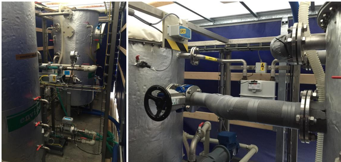
Obr. 25 Poloprovozní AnMBR - úpravy propojovacího potrubí mezi membránovou komorou a anaerobním reaktorem - uzávěr a tepelná izolace (foto autor)
