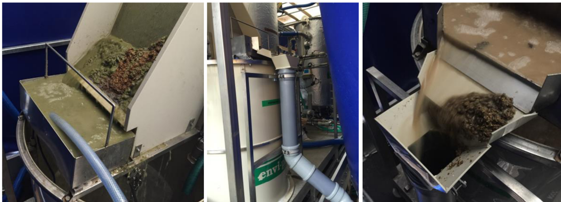
Obr. 23 Poloprovozní AnMBR - zahlcení sběrného koše mechanického předčištění a dobudování přepadu na shrabky (foto autor)
