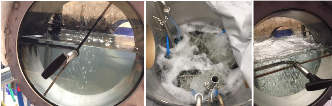
Obr. 27 Poloprovozní AnMBR - kontrola aeračního systému membránových modulů (foto autor)
