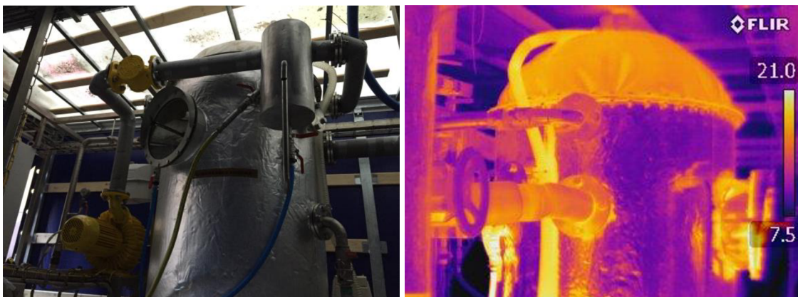
Obr. 32 Poloprovozní AnMBR - zateplení větve bioplynu a kontrola úniků IR kamerou (foto autor)
