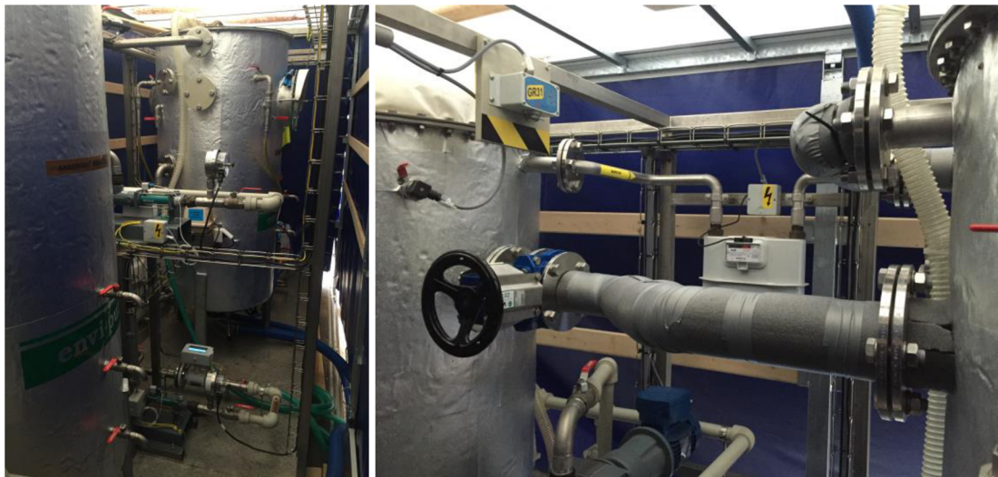
Obr. 25 Poloproduční AnMBR - úpravy propojovacího potrubí mezi membránovou komorou a anaerobním reaktorem - uzávěr a tepelná izolace (foto autor)
