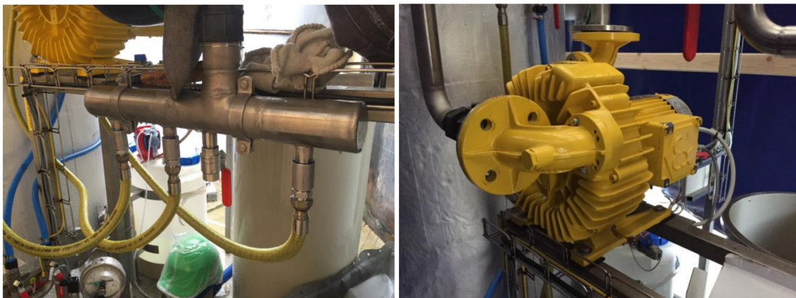
Obr. 29 Poloprovozní AnMBR - rozdělovací objekt větve bioplynu s dodatečnou výpustí kondenzátu, čištění dmyhadla bioplynu (foto autor)
