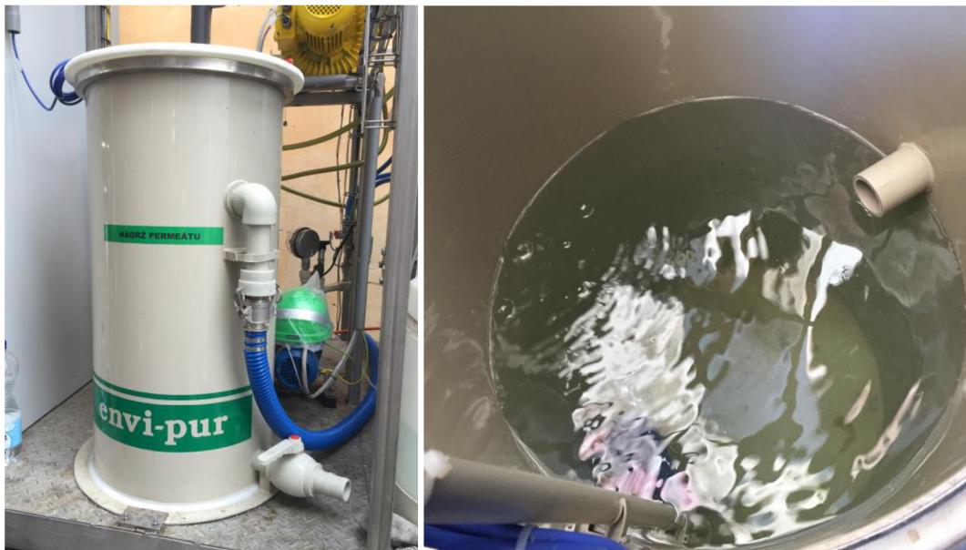
Obr. 16 Poloprovozní AnMBR - nádrž permeátu (foto autor)
