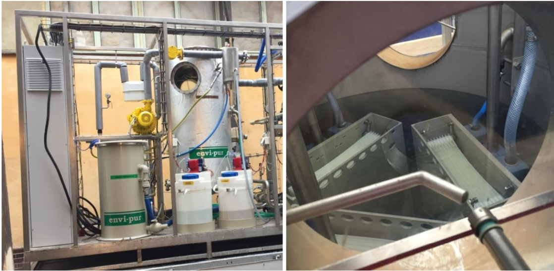
Obr. 15 Poloprovozní AnMBR - membránová komora, membránové moduly (foto autor)
