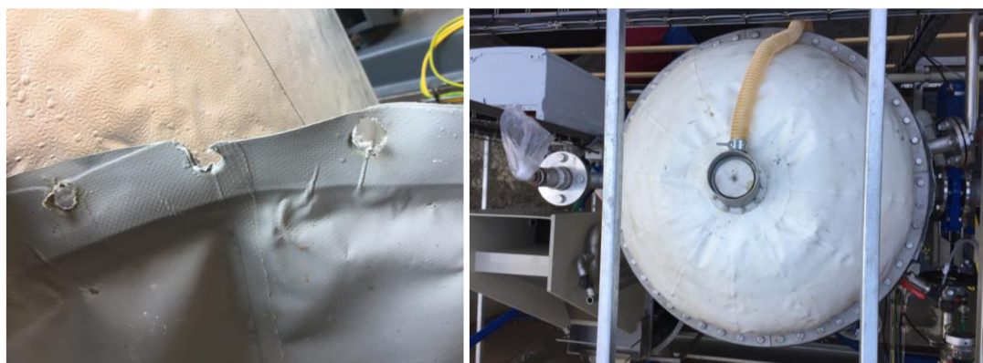
Obr. 34 Poloprovozní AnMBR - identifikace úniků, zkouška plynotěsnosti (foto autor)
