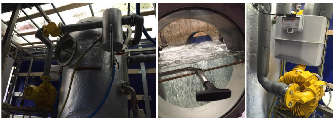
Obr. 18 Poloprovozní AnMBR - plynové hospodářství (foto autor)
