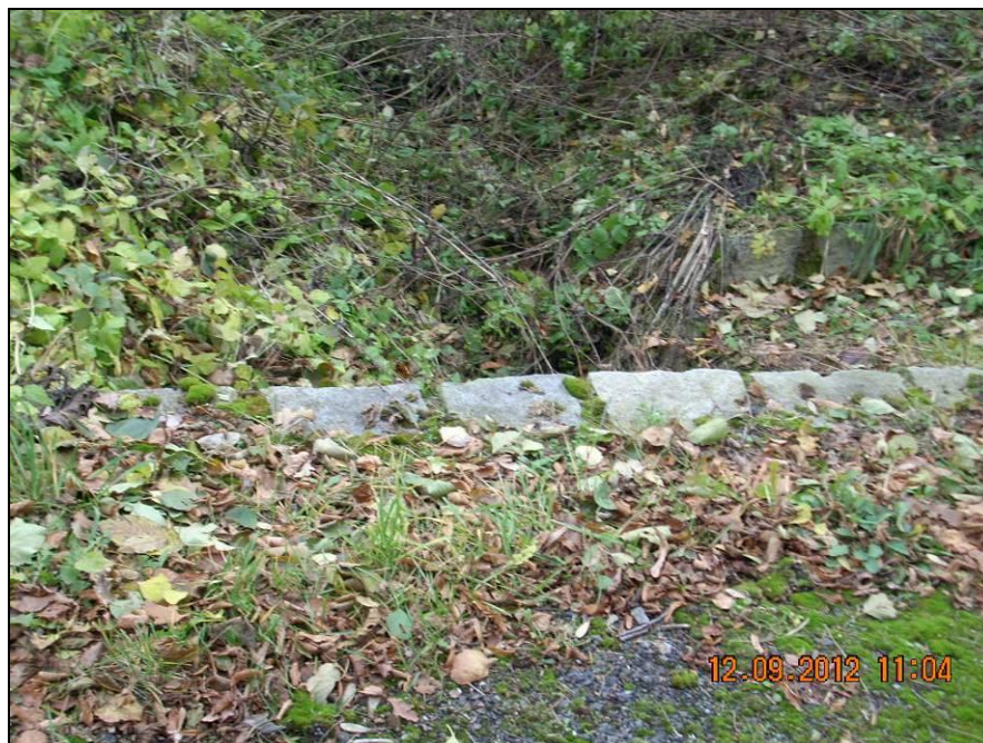
Obr. č. 23: Neudržovaná cesta HC1. Autor Pavlína Štanglová.
