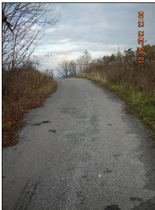
Obr. č. 21: neudržovaná cesta HC1. Autor Pavlína Štanglová.
