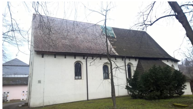
Obrázek č. 18: Kostel sv. Jakuba stav střechy (Autorská fotografie)
