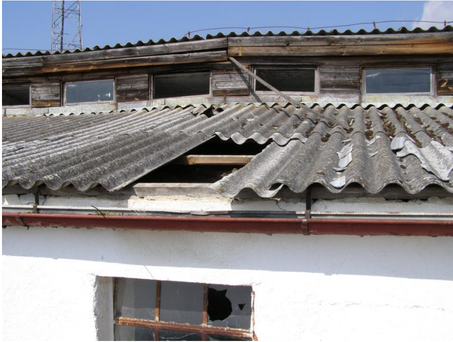
Foto č.2: Porušení střešní krytiny („Foto Petr Horký“)
