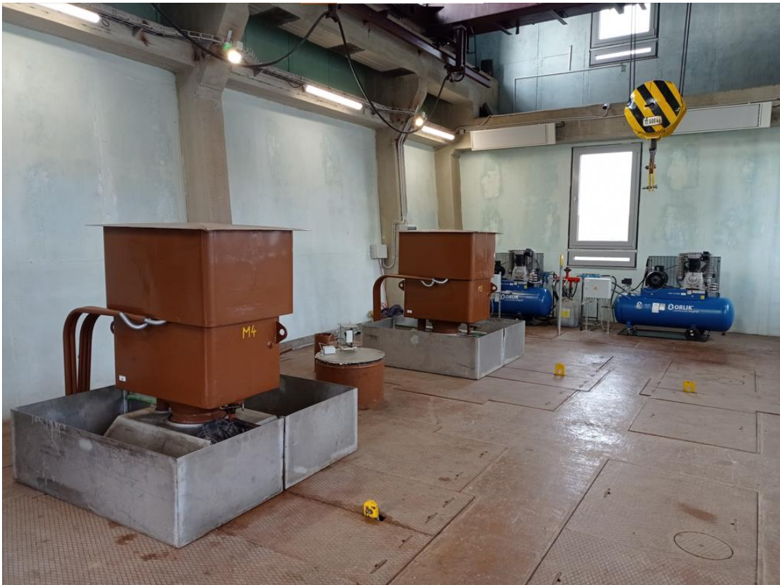
Obr. 16 Interiér strojovny vtokového objektu [30]
