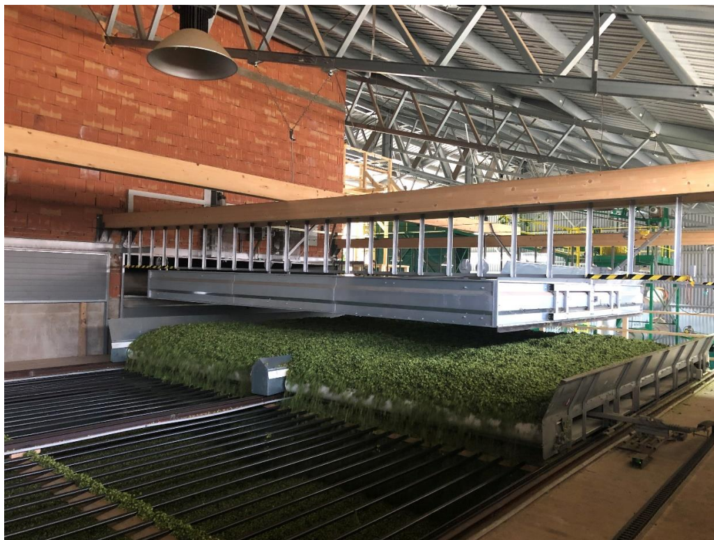
Obr. 13 Vyprazdňování sušicího vozíku a plnění uklidňovací komory
