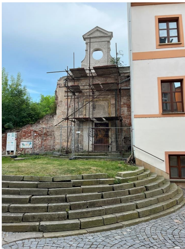
Obr. č. 67 Ruiny zaniklého domu čp. 122 v roce 2024 (foto P. Bártík)
