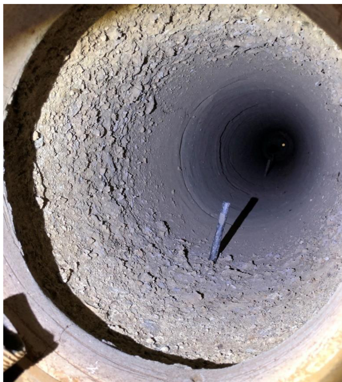
Obr. 10 Nápeky ve vstupní části pece po spalovací zkoušce s MIX 2 – 4
