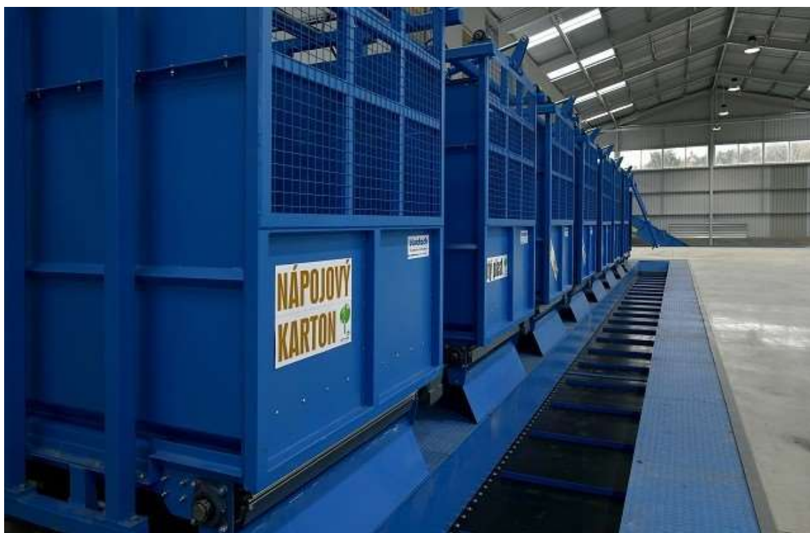
Obrázek 10 Fotografie zásobníků na vyseparovaný odpad
