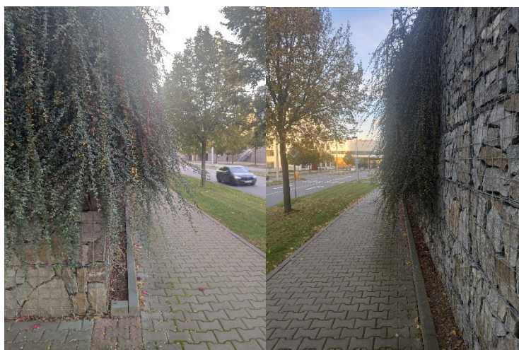
Obr. 227 Okrasné keře zasahující do průchozí šířky chodníku
