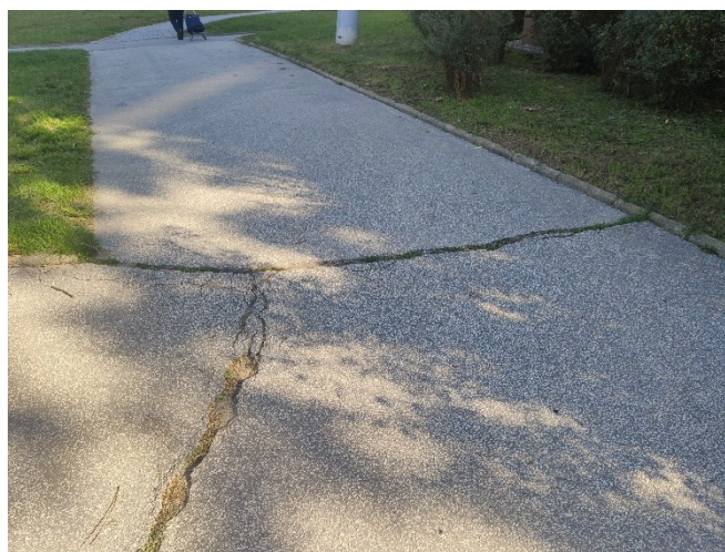
Obr. 56 Špatný technický stav chodníku v ulici Běloruská
