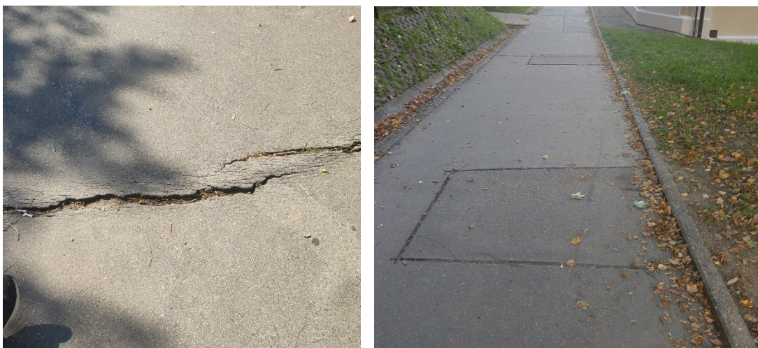
Obr. 112 Nejčastější poruchy povrchu
