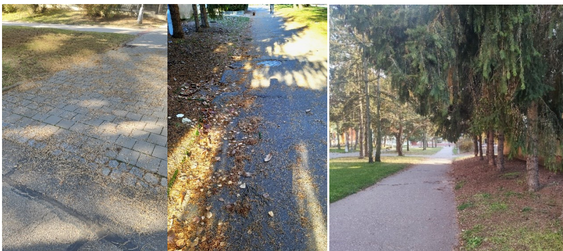
Obr. 68 Chybějící obrubníky mezi chodníkem a zelení
