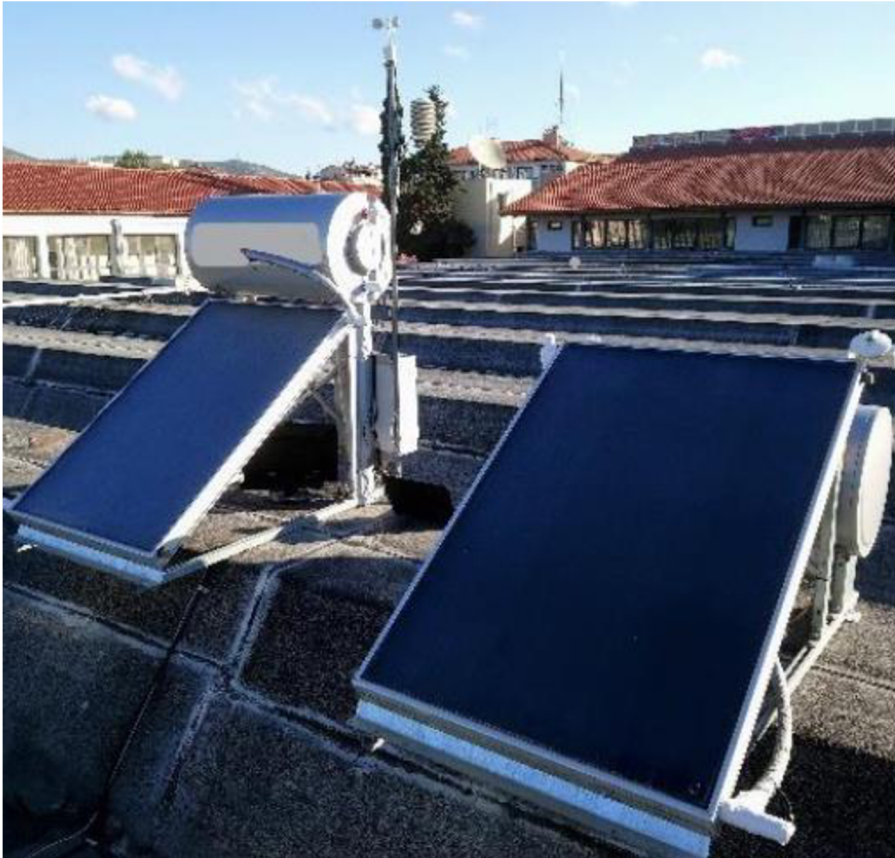
Obr. 10 Kapalinový solární panel se zásobníkem a výměníkem tepla - foto (13)
