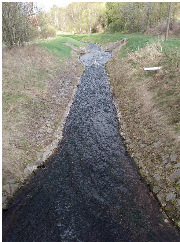
Obrázek 39: Opevněné koryto Loučenského potoka (fotografie č. 7)
