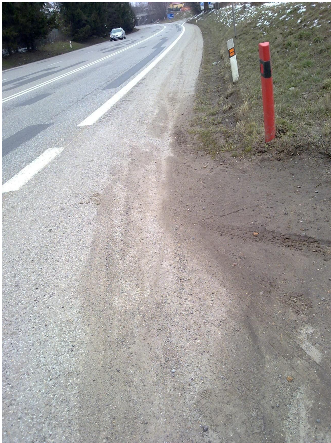
Obrázek 22 – Měřicí místo č. 3 – Silnice I. Třídy – E55 – u sjezdu na Boršov n./vlt.- pohled směrem k Českým Budějovicím, detail znečištění z vedlejší komunikace
