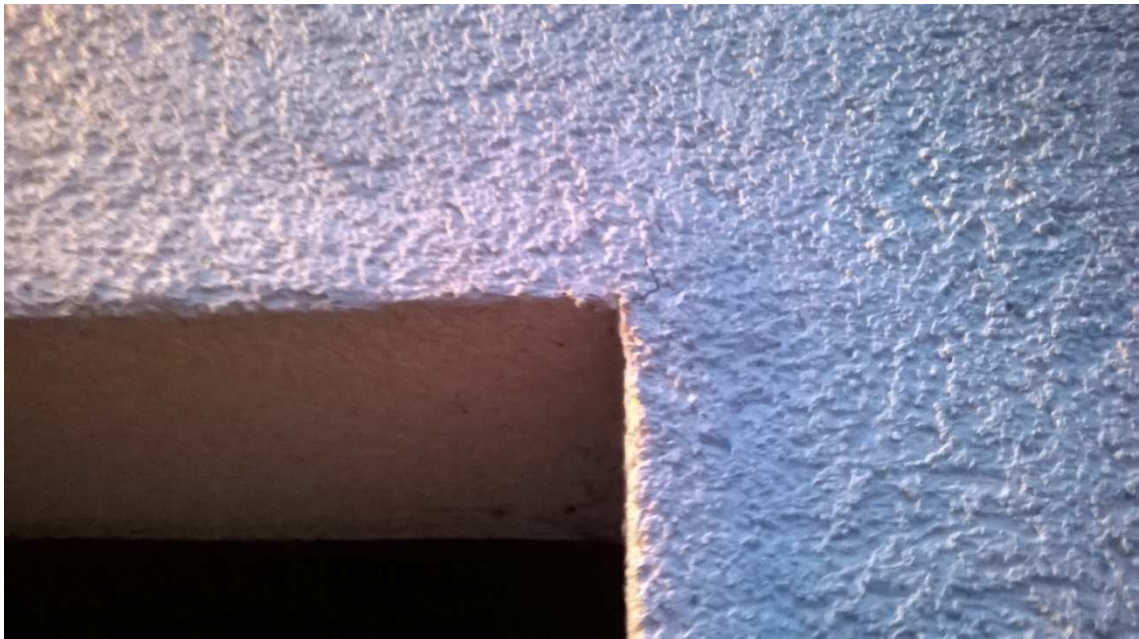
Obr. 16- Vystupující pruh fasády v oblasti tepelné izolace ostění (6)
