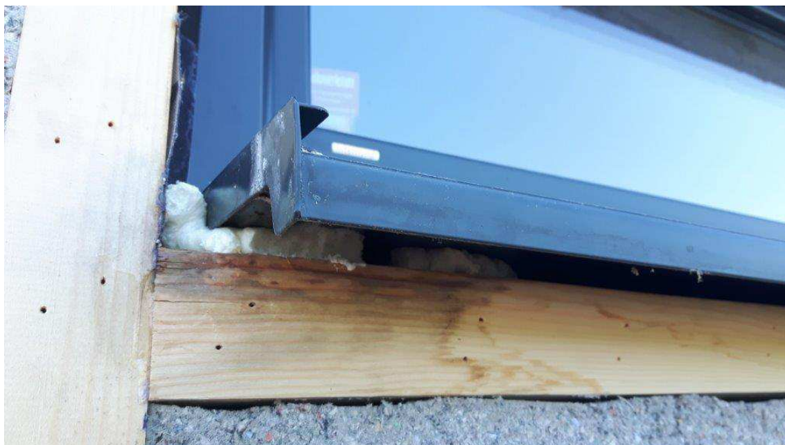
Obr. 15- Vzniklá hniloba konstrukce pod parapetem (5)
