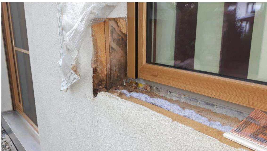
Obr. 14 - Vzniklá hniloba v konstrukci pod parapetem (5)
