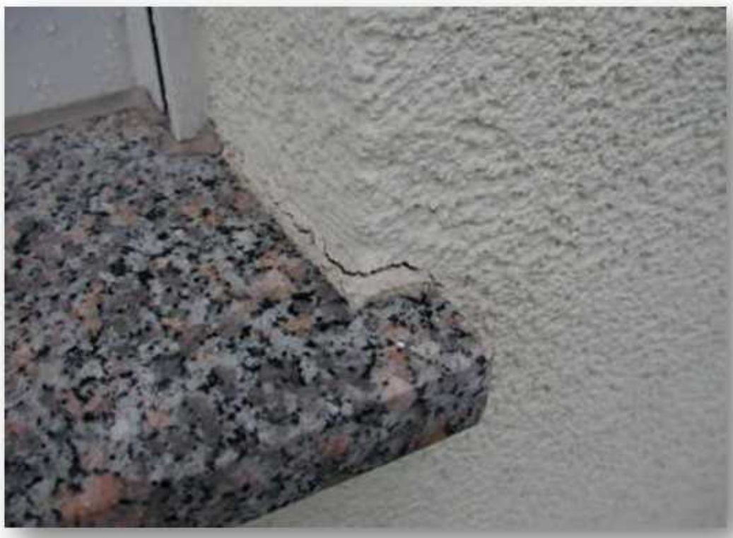
Obr. 13 -Prasklina v napojení fasády na parapet (5)
