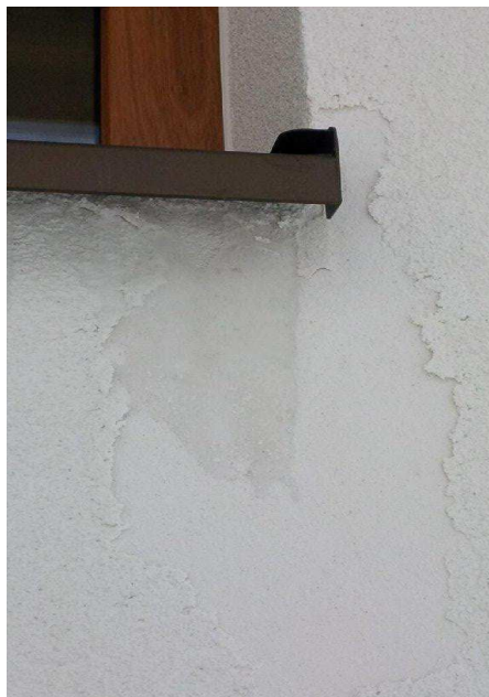
Obr. 12- Olupování omítky v místě koncovky parapetu (5)
