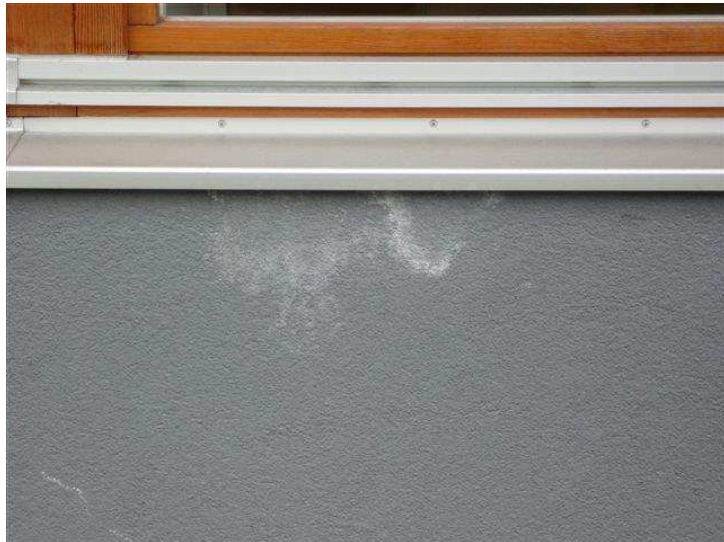
Obr. 11- Vzniklé skvrny na omítce vlivem výtoku vody (5)
