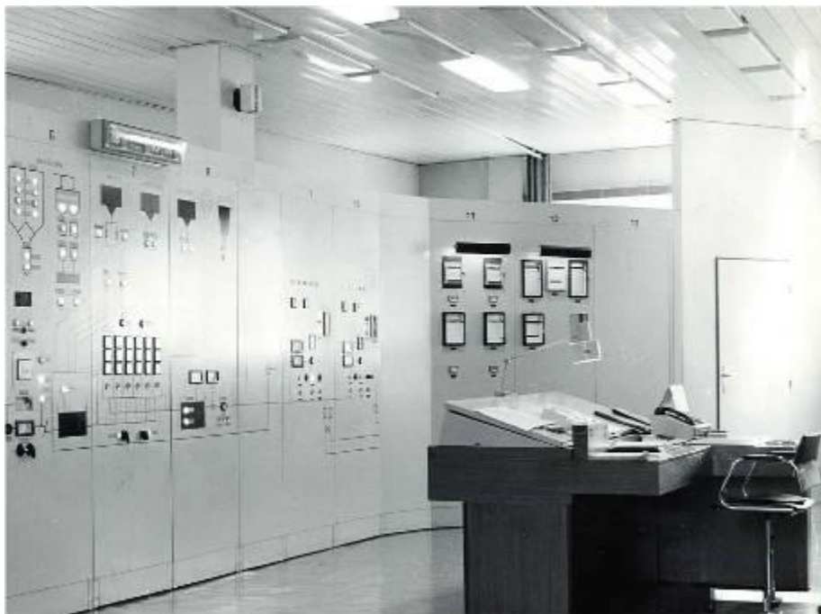
Obrázek č. 3: historické foto velína (foto: Ing. Baláž 1985)
