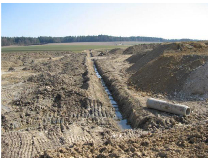
Obrázek 12 -Fotodokumentace průtočné stoky
