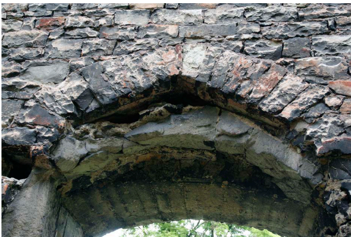
7. detail zaklenutí portálku s otiskem bednění (foto autor).
