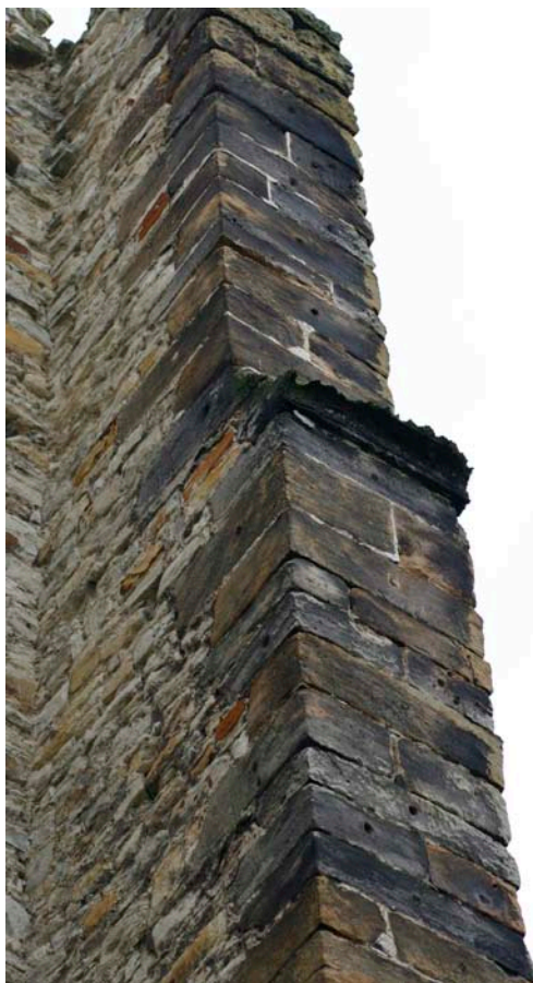
13. Vnější opěrný pilíř presbytáře se zbytky stříšky (foto autor).
