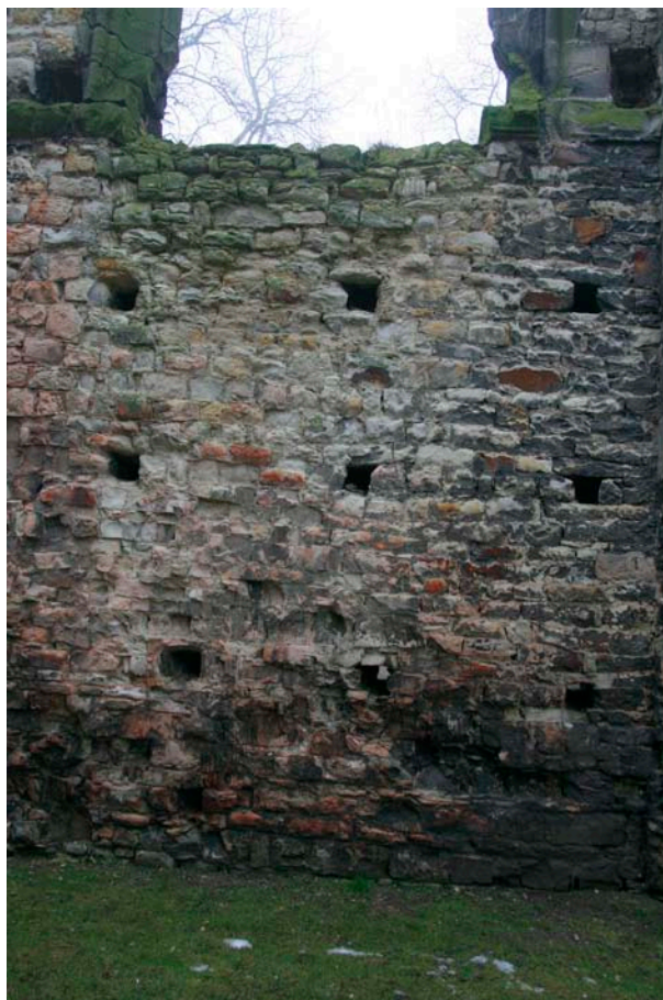
15. Jižní stěna presbytáře poškozená požárem (foto autor).
