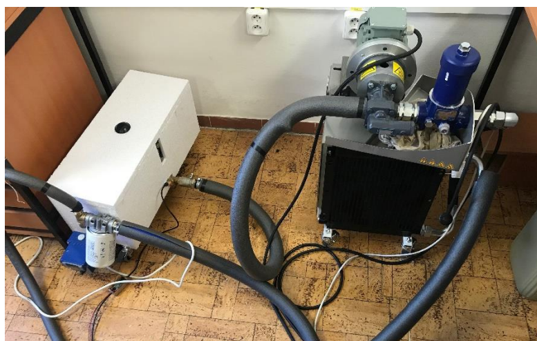
Obr. 56 Ukázka izolace olejové vany a potrubí.
