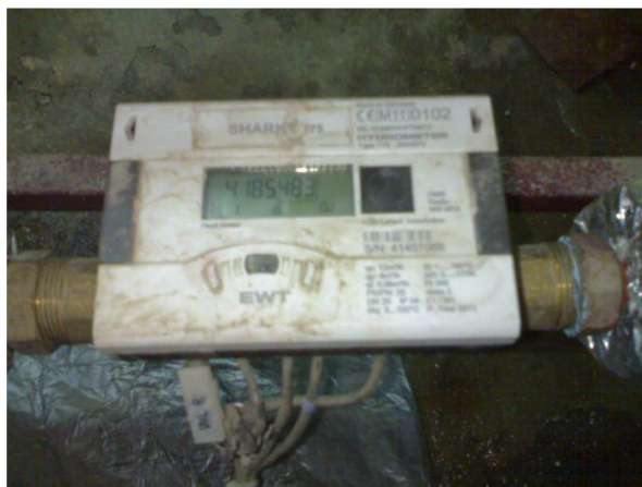
Obrázek 31 Pravidelné odečty spotřeby tepelné energie pro přípravu teplé vody – SHARKY 775
