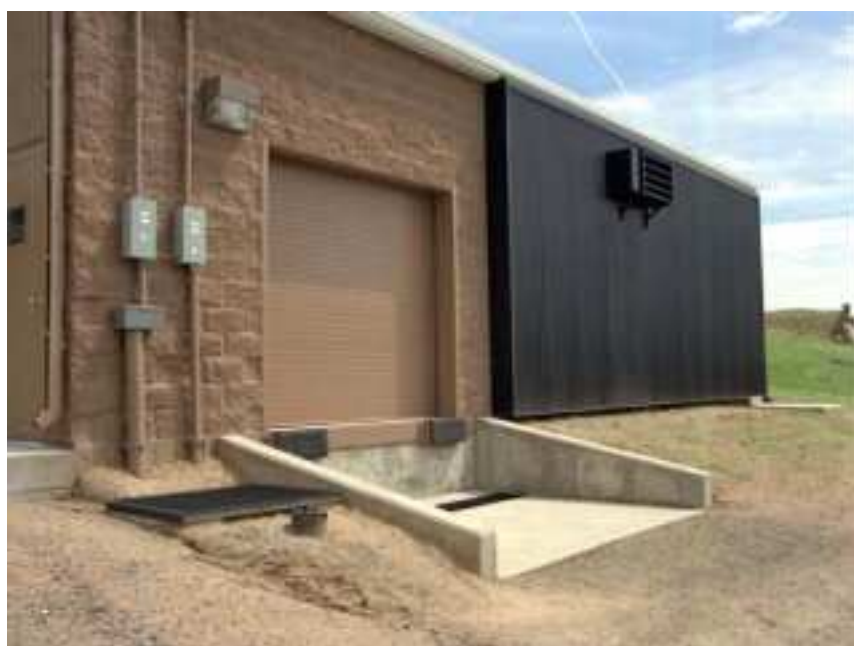
Vzduchový kolektor na fasádě
