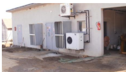
Obrázek 27: Budova s kogenerátorem
