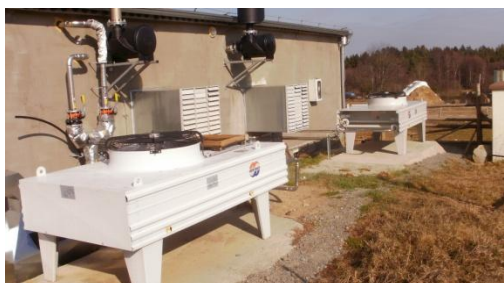
Obrázek 32: Odvody teplého vzduchu
