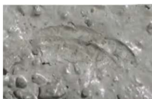
Obrázek 6 - Dostatečně zatvrdlý beton
