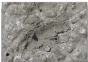
Obrázek 7 - Nedostatečně zatvrdlý beton
