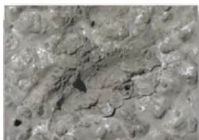
Obrázek 7 - Nedostatečně zatvrdlý beton
