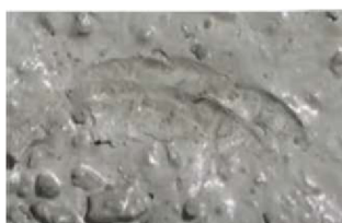
Obrázek 6 - Dostatečně zatvrdlý beton
