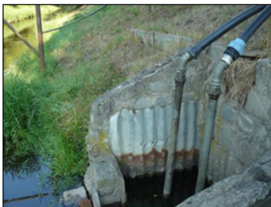
Obr. č. 43: Detail zařízení k čerpání vody, pravý břeh (Dvořáková, 2015)
