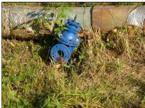
Obr. č. 37: Výpust' mezi OM 1 a 2 (Dvořáková, 2015)
