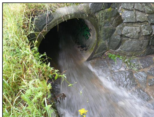
Obr. č. 46: Kanalizační odlehčovač (Dvořáková, 2016)
