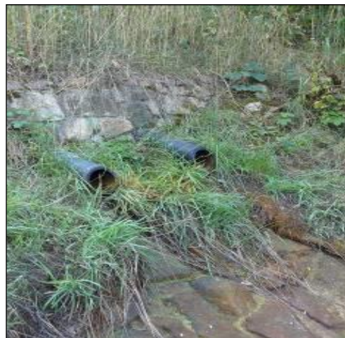
Obr. č. 39: Výpust' mezi OM 1 a 2 (Dvořáková, 2015)
