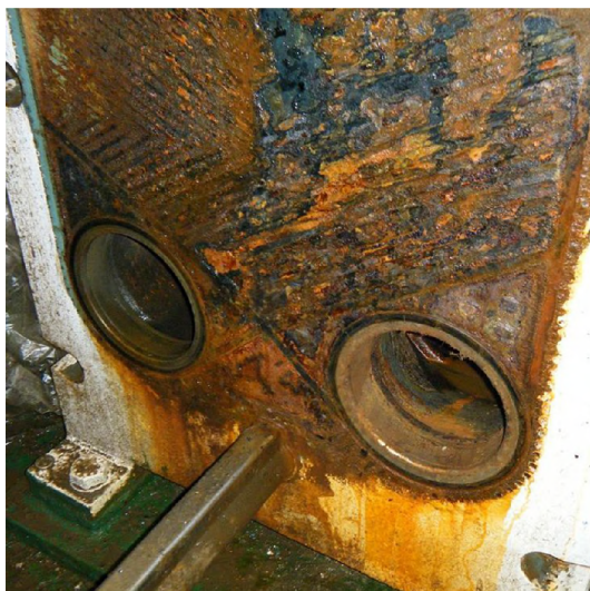
Obr. 27: Korózia doskového výmenníka tepla [3]
