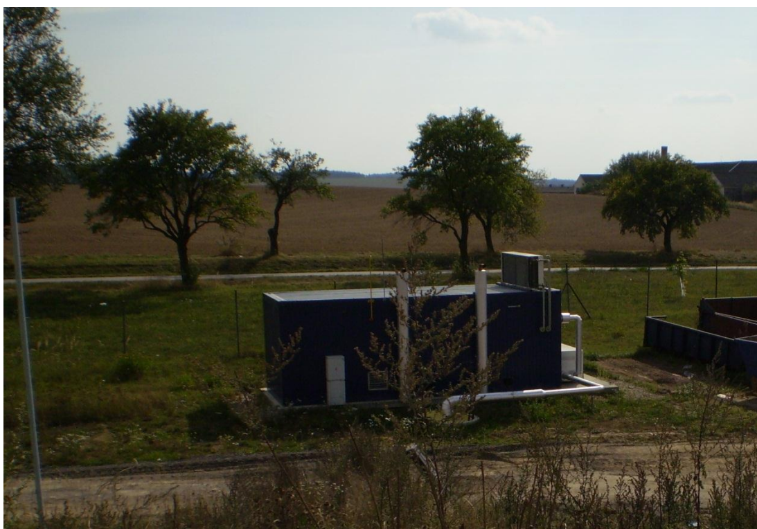
Foto: autor Kogenerační jednotka
