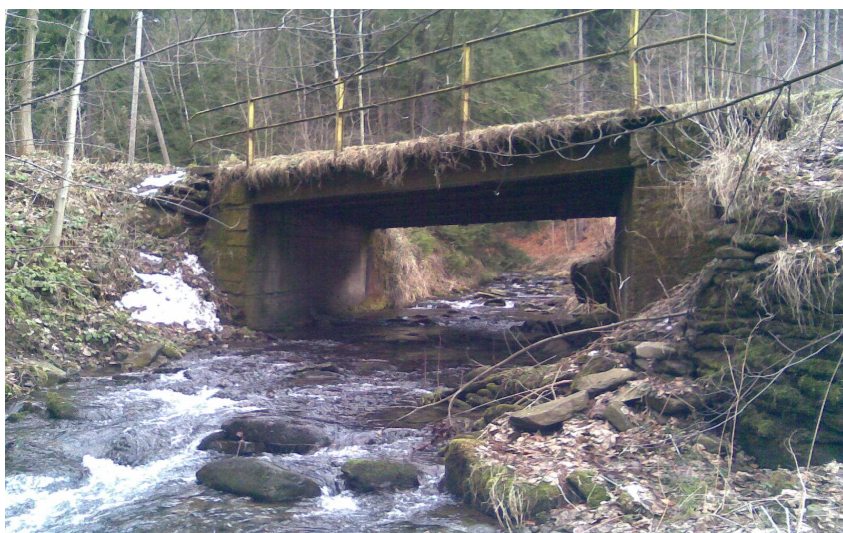
Obr. č. 11: Nevyhovující most č. 4 na řece Kopytné (Lucie Čmielová).
