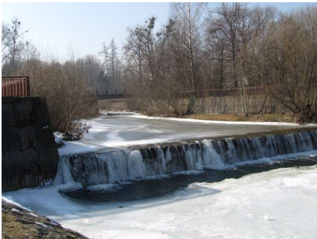
Obr. č. 7: Kritické místo na řece Olši, most č. 5 a jez č. 6 (foto: Lucie Čmielová).
