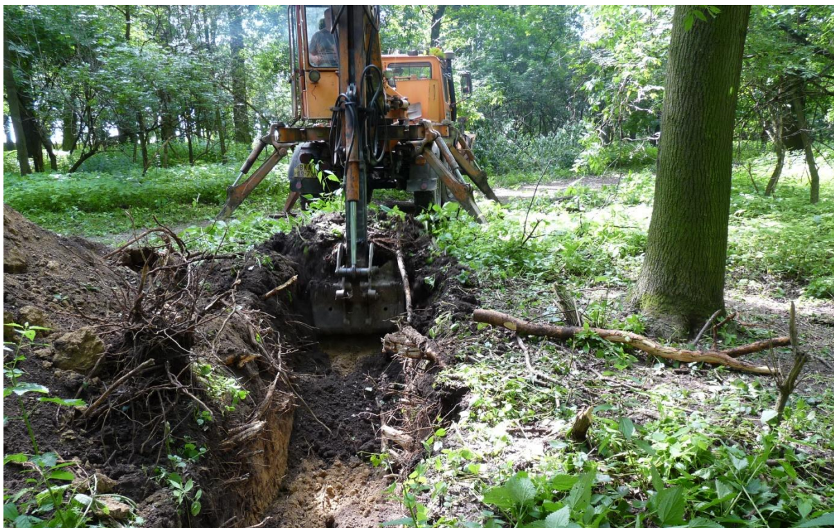
Príloha 13. Poškození kořenového systému ve vzdálenosti 1,5 m od kmene, strom č. 2
