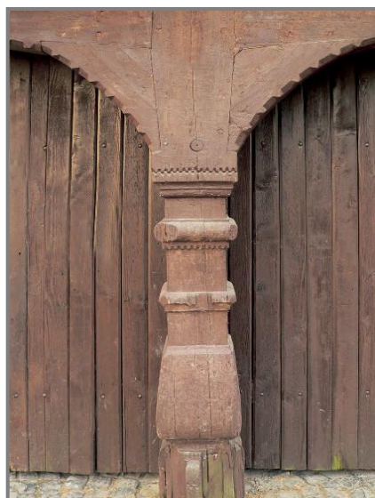
Obrázek 16 Sloup podstavky s profilací balustry; Krásná Lípa, foto Václav Sojka, zdroj: www.drevoastavby.cz
